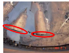
浮艙和甲板破損
