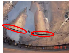
ポンツーンとデッキ板の破断
