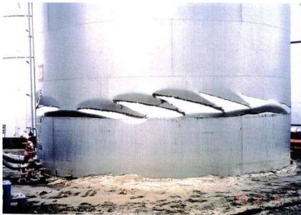
阪神淡路大震災，石油儲槽發生鑽石型底部變形 (容量:990kl，地震時液體高度:13.2m，儲槽内徑:9.67m)
