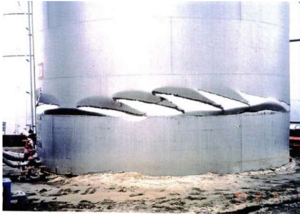
阪神・淡路大震災において発生した石油タンクの「ダイヤモンド型」座屈変形 (容量: 990kℓ、地震時液面高さ: 13.2m、タンク内径: 9.67m)
