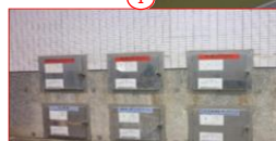
高科技廠管線檢修口
